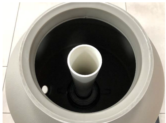
Abb. Innenverrohrung stehend (mittig) im Filterkessel
